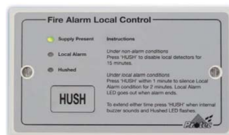
Módulo de Supervisão e Comando
